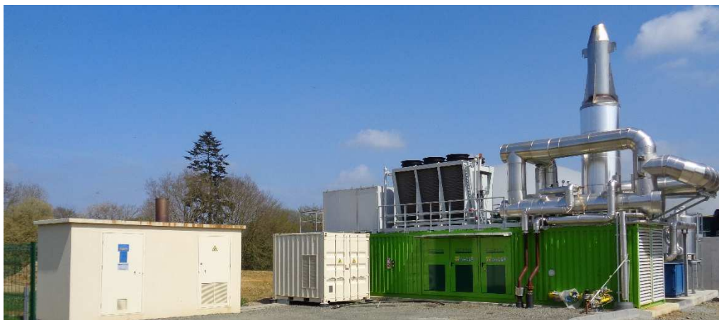
Photographie : à droite : conteneur du moteur de cogénération biogaz : au centre : Transformateur électrique ; à gauche : Poste de livraison de l'électricité verte produite sur le réseau de distribution public.
